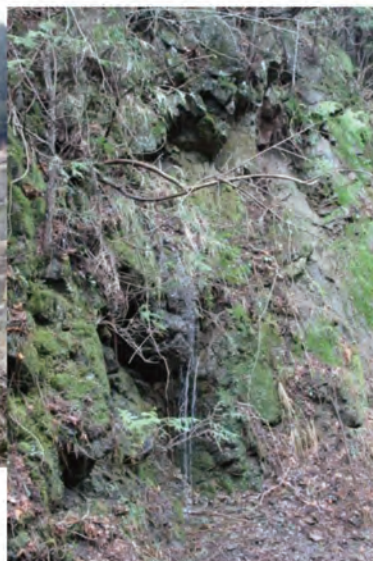
浸水が湧き出る法面
