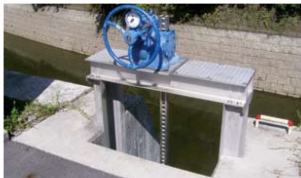
大門川への手動式取水ゲート（大安寺町）
