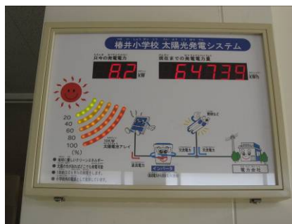
発電システム表示板
