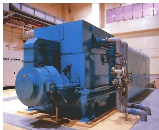
蒸気タービン発電機
