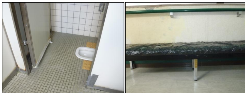
＜トイレの扉をテープで補修している＞ ＜ソファアーにビニール袋をかぶせている＞
