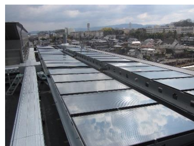
太陽熱温水器 集熱パネル (北部会館)
