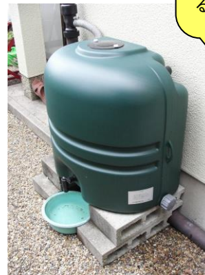
うすい 雨水タンク
