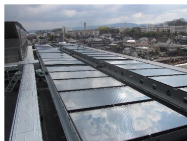
太陽熱温水器 集熱パネル （北部会館）
