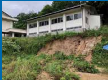
興東館柳生中学校の土砂くずれ
