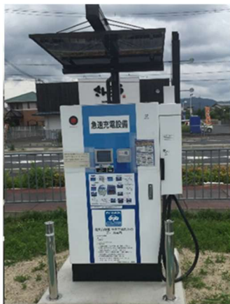
電気自動車の充電設備
