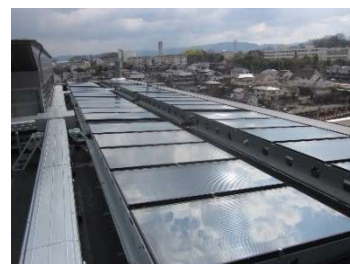
太陽熱温水器 集熱パネル (北部会館)
