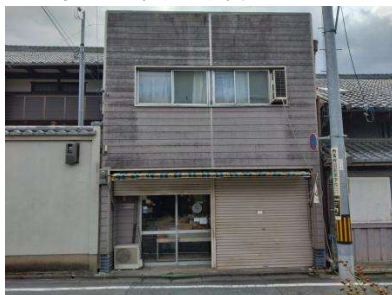
【修理前】 令和6年10月30日撮影
