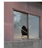
窓が割れた 管理不全空家
