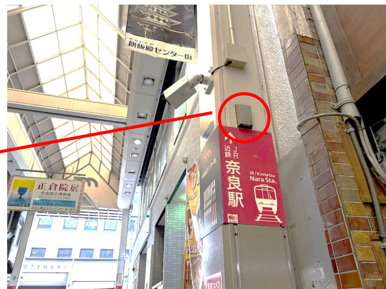
コンセントによる電源供給
