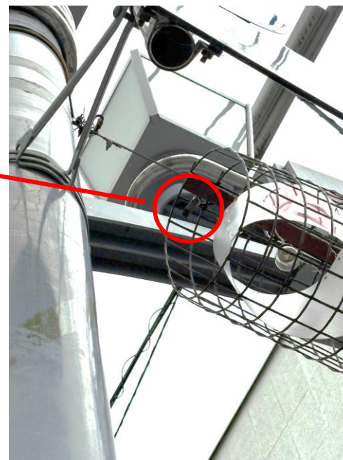
コンセントによる電源供給
