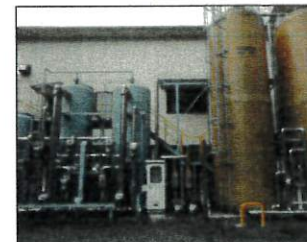
<第二工区の水処理施設>
