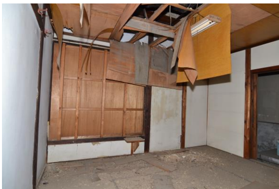
休憩室の天井の脱落
