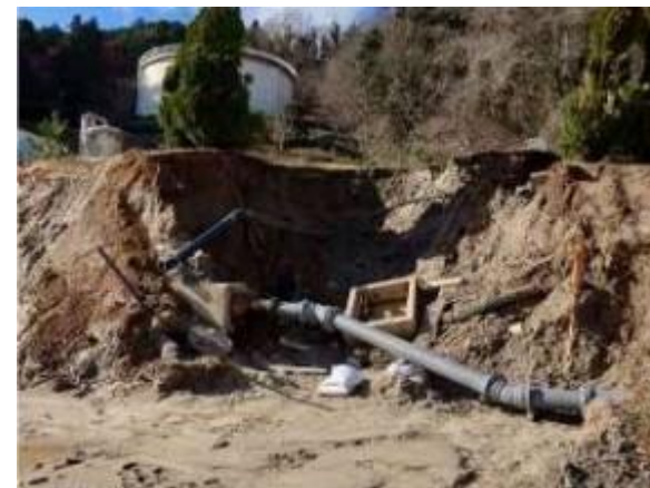
七尾市岩屋浄水場（場内配管損傷）
