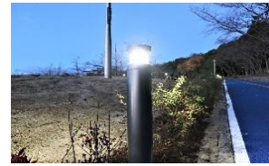
ランニングコース夜間照明
