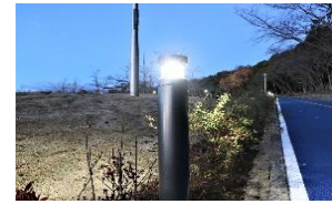
ランニングコース夜間照明
