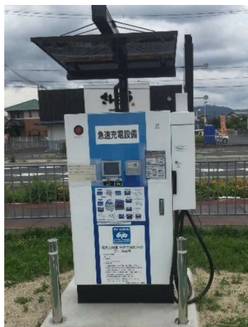
電気自動車の充電設備
