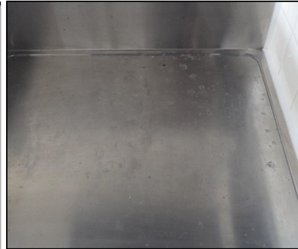
A : コンロ 錆汚れがあります
