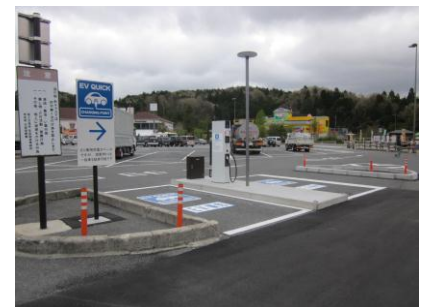
道の駅針テラス 急速充電設備
