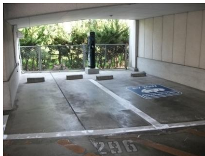
本庁舎 普通充電設備
