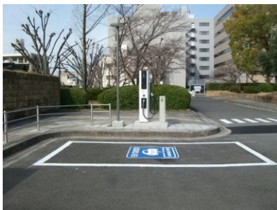
本庁舎 急速充電設備
