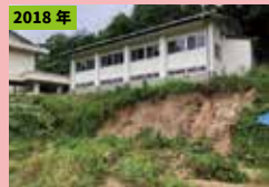
興東館柳生中学校の土砂くずれ
