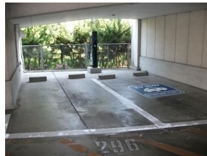
本庁舎 普通充電設備
