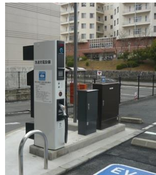
北部会館 急速充電設備
