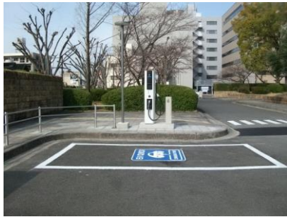
本庁舎 急速充電設備
