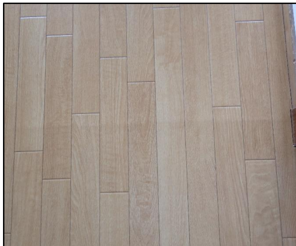
A : 台所床 少し浮きがあります。
