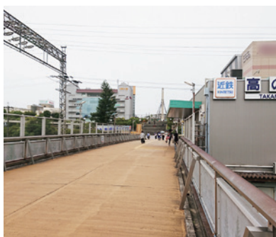
耐震補強工事が求められる高の原橋
