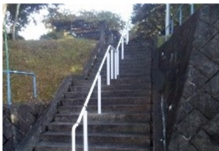
既存階段に取り付けられた手摺り
