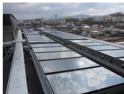
太陽熱温水器 集熱パネル （北部会館）
