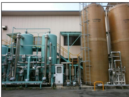
< 第二工区の水処理施設 >
