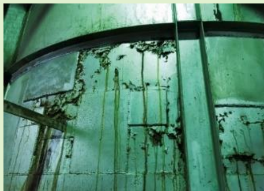
塗装が傷み、錆が流れる焼却炉
