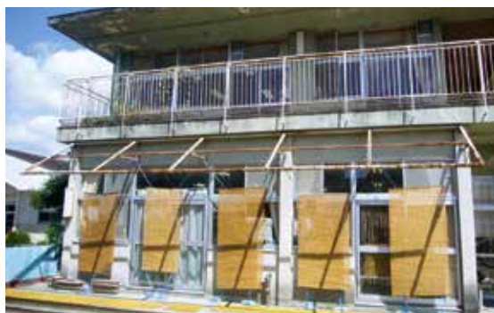
補修が必要な開放廊下 (高円保育園)
