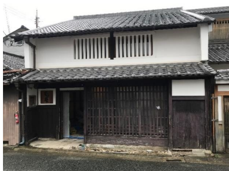
【修理前】 令和元年8月20日撮影
