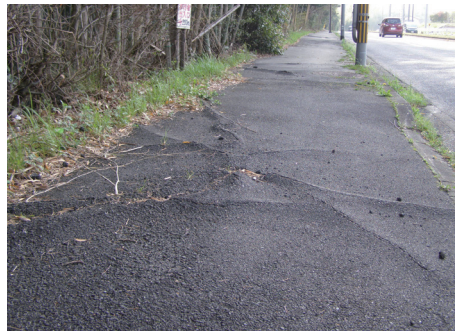
地面が盛り上がり危険な状態の歩道
