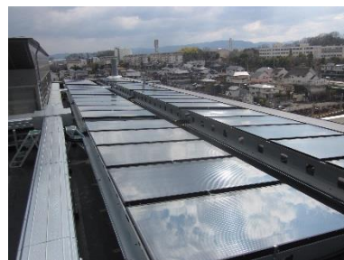
太陽熱温水器 集熱パネル （北部会館）
