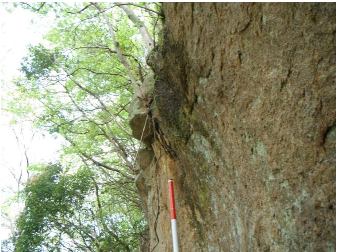
P-60 : 露頭上方に開口亀裂が発達しており、ブロック状に分離が進行している。
