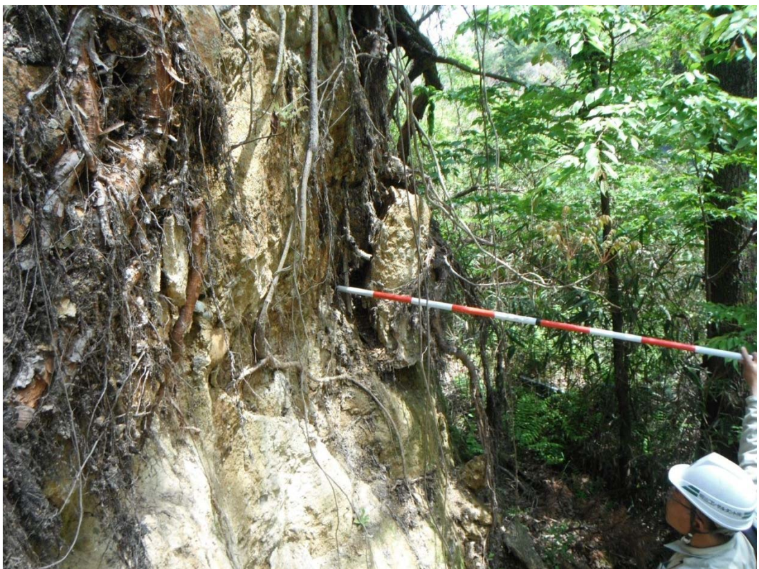
P-42 : 20cm 幅の開口がある亀裂。樹木の根が入り込み、開口の進行を助長している。 層理面は N75E 72N。
