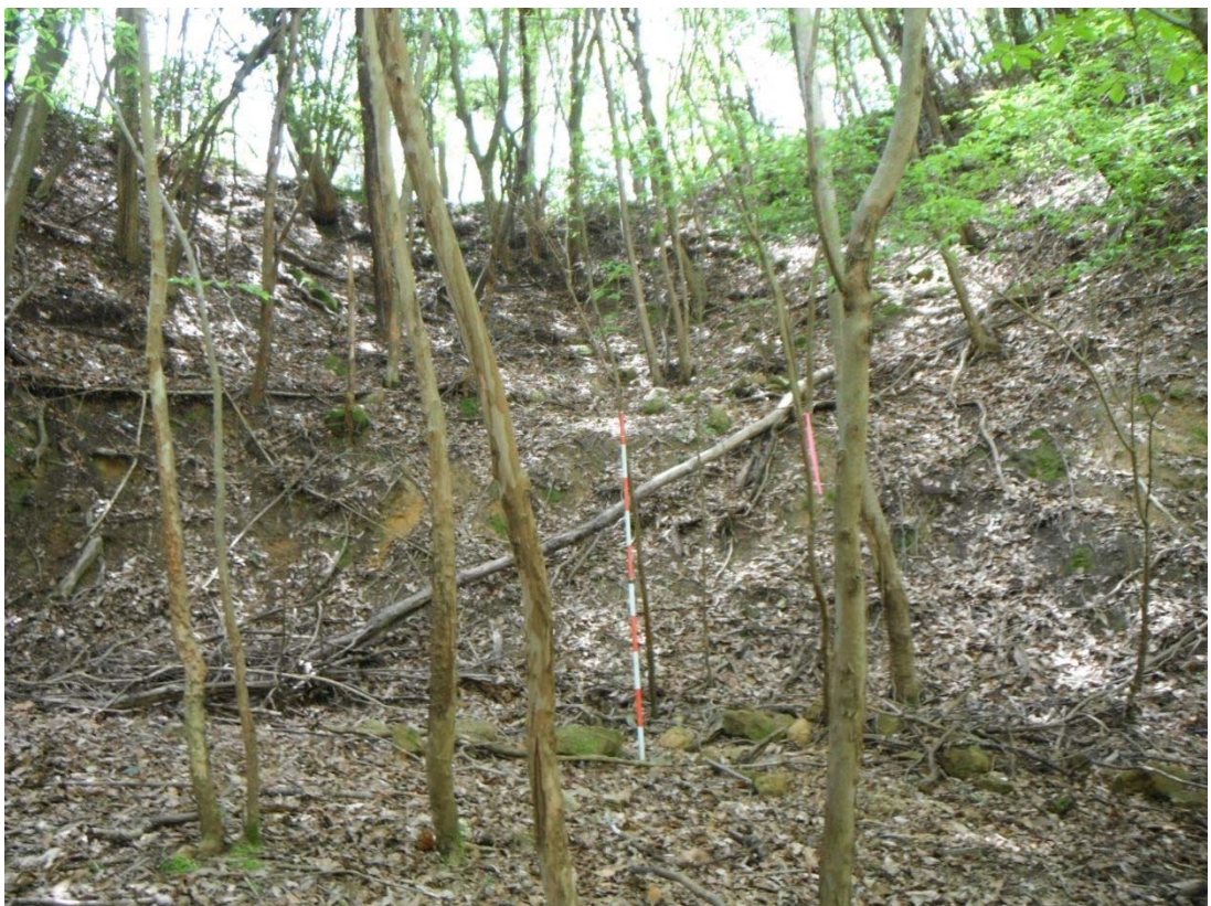
P-50：谷部の崩壊跡。滑落崖に岩盤は確認されない。
