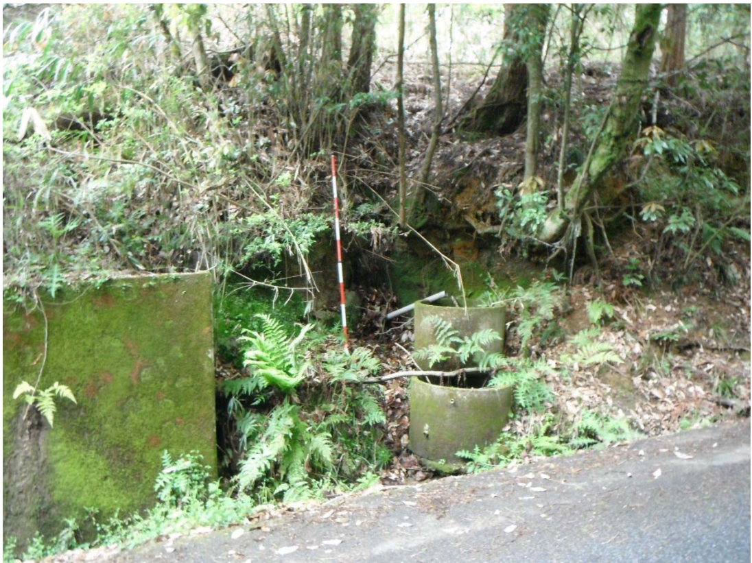
P-36 : P-21 の湧水が伏流し市道の法尻で再び湧出する。
