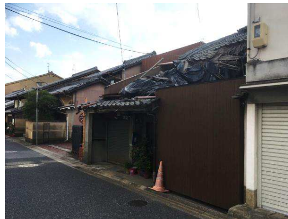
【屋根が崩落した町家】
