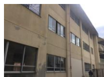
現状 ひび割れ、吹付材の 剥離等
