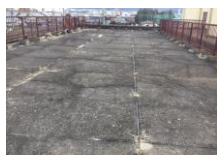
現状 保護コンクリートの ひび割れ、目地の破 損、雑草
