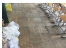
現状 仕上げの摩耗
