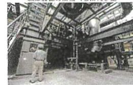
焼却炉設備の運転操作
