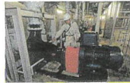
ポンプ設備の日常点検
