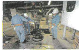
水中攪拌機設備の定期点検
