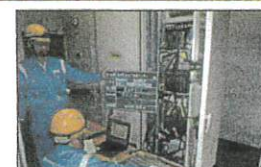
中央監視設備の点検
