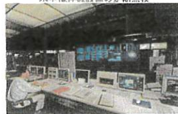
監視室における運転監視
