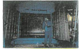
除塵設備の日常点検
