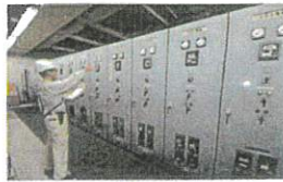
受電設備の日常点検
