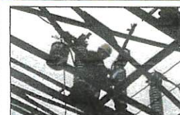
受変電設備の点検
