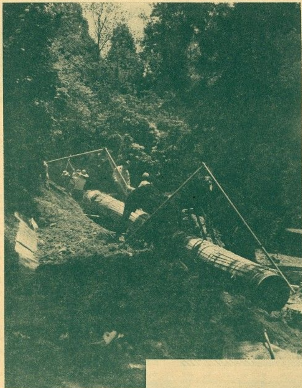
東大寺・奈良公園・春日大社を通 って布設される直径500mmの幹線配 水管路
