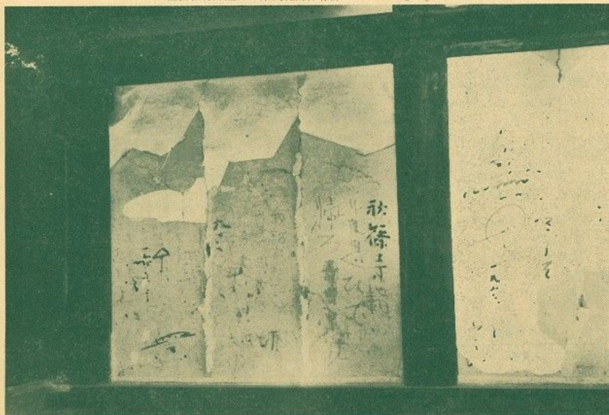
秋篠寺本堂の白壁が崩れ、下地に彫り込むように落書がされています。
