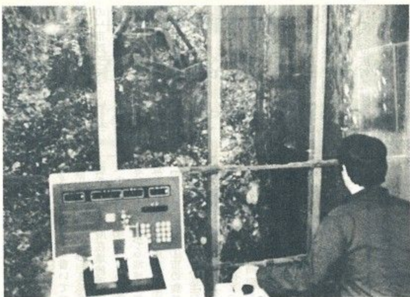
中央制御室で、溜まったゴミを焼却炉へ運ぶクレーンの操作を集中管理する
