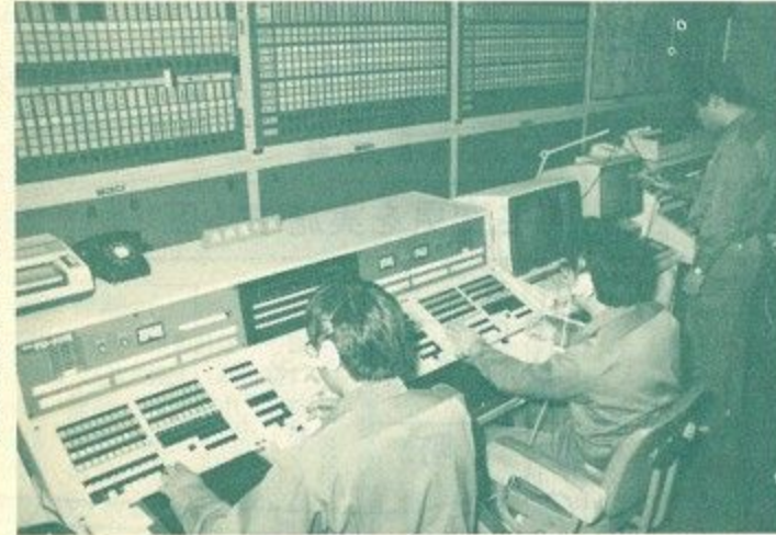
コンピューター化された市消防本部通信指令室での監視
