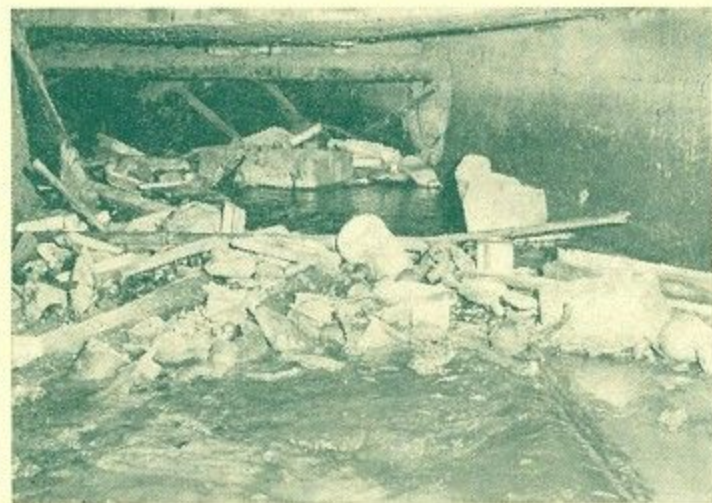
ああ、痛ましい！ 大型ゴミで埋まった暗渠下水道の入口
