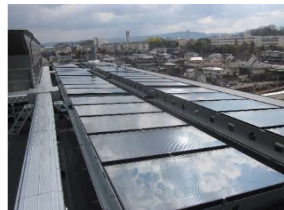
太陽熱温水器 集熱パネル (北部会館)
