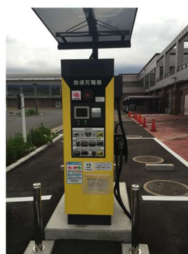
じどうしゃ じゅうでんせつび 電気自動車の充電設備
