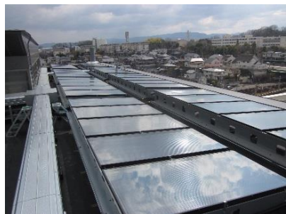
太陽熱温水器 集熱パネル (北部会館)
